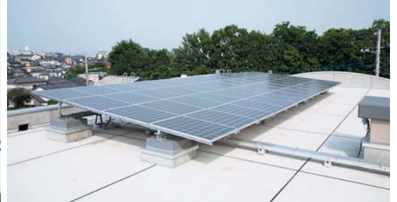
太陽光発電設備
