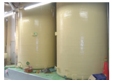
薬品注入機室 [1階]
