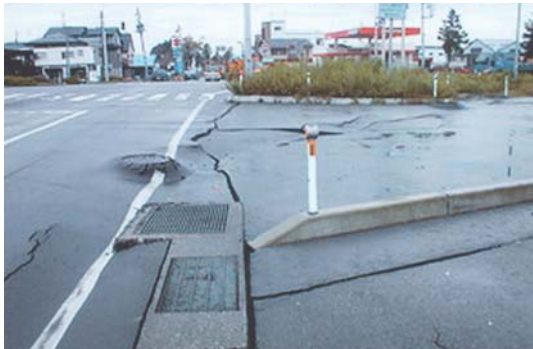
新潟県中越地震の被害状況
