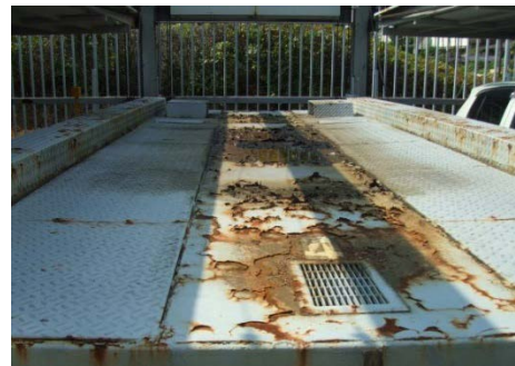
図 4-2-14 立体駐車場の腐食
