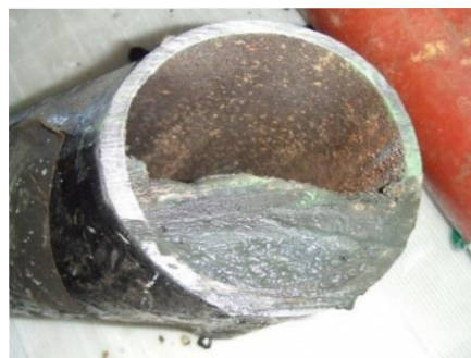
図 4-2-8 堆積物による排水管詰まり
