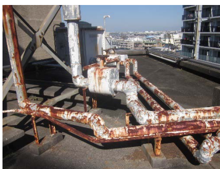
図 4-2-7 錆びついた給水管
