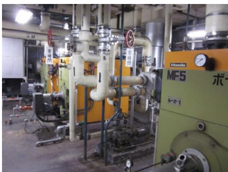
図 4-2-11 更新時期を迎える熱源設備
