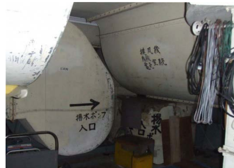
図 4-2-12 老朽化する空調関連設備
