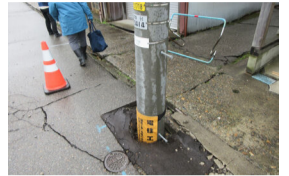
液状化により沈んだ電柱 (富山県高岡市)
