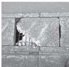
側溝ふた破損
