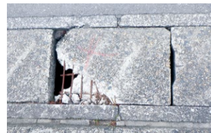
側溝ふたの破損
