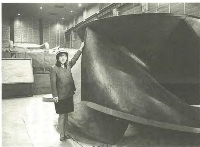
ポンプ内のスクリュー。毎分60回転で排水します
