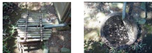
⑫-1 雨水排水設備（溜め壺型）〔使用者の間東側〕
