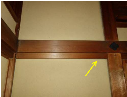
離座敷棟・次の間北面の壁のチリ切れ
