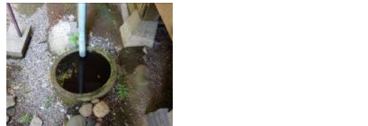
⑫-7 雨水排水設備（溜め壺型）〔離座敷棟西側〕
