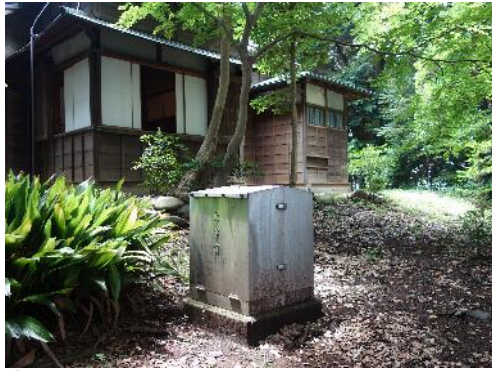
㊹-2 放水銃(令和7～8年度の工事により易操作性消火栓へ切替予定)
