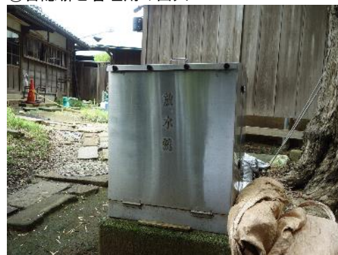
㉙-1 放水銃(令和7～8年度の工事により易操作性消火栓へ切替予定)
