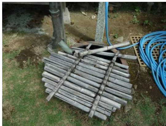
竹製の蓋の破損
