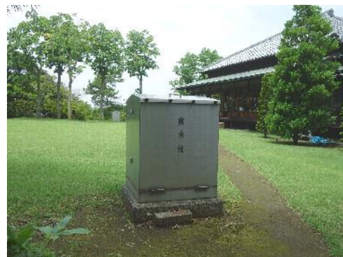
㊹-5 放水銃(令和7～8年度の工事により易操作性消火栓へ切替および設置場所変更予定)
