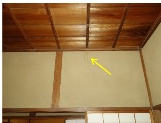
中座敷棟・化粧室北面の雨染み
