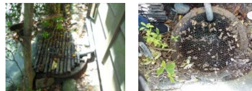
⑫-2 雨水排水設備（溜め壺型）〔使用者の間東側〕
