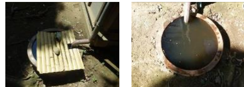
⑫-8 雨水排水設備（溜め壺型）〔離座敷棟東側〕
