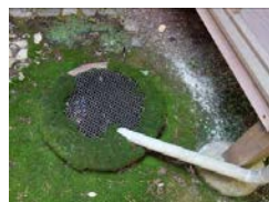
㉒-3 雨水排水設備（溜め壺型）〔使用者の間北東側〕
