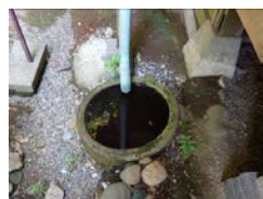
㉒-7 雨水排水設備（溜め壺型）〔離座敷棟西側〕
