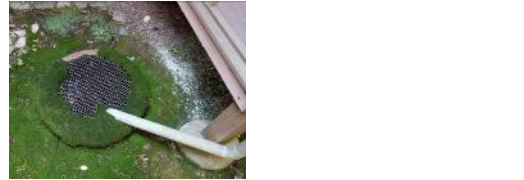
⑫-3 雨水排水設備（溜め壺型）〔使用者の間北側〕
