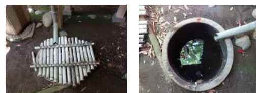
⑫-6 雨水排水設備（溜め壺型）〔離座敷棟南側〕
