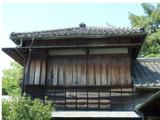
台所棟二階南面の屋根瓦のズレや脱落
