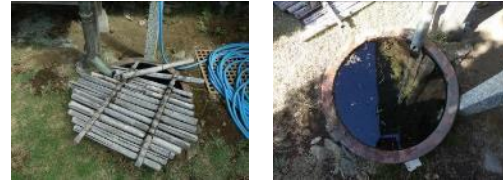
⑫-4 雨水排水設備（溜め壺型）〔表座敷棟南側〕
