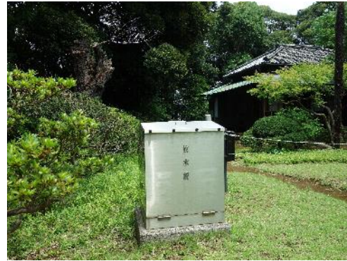
㊹-3 放水銃(令和7～8年度の工事により易操作性消火栓へ切替および設置場所変更予定)
