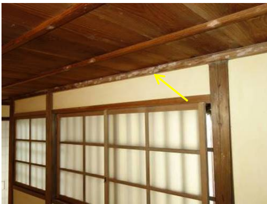
玄関棟・内玄関の西廊下の西面のパテ
