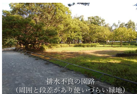
排水不良の園路 (周囲と段差があり使いづらい緑地) 図 2-2-4 新拠点ゾーンの課題②
