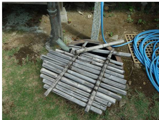
竹製の蓋の破損
