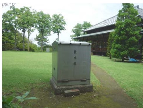
㊹-5 放水銃（令和7～8年度の工事により撤去予定）
