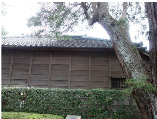
屋根や軒樋に落葉などが溜まる（使者の間の東側）
