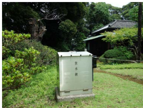
㊹-3 放水銃（令和7～8年度の工事により撤去予定）
