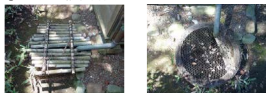
⑭-1 雨水排水設備（溜め壺型）〔使用者の間東側〕
