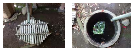
⑭-6 雨水排水設備（溜め壺型）〔離座敷棟南側〕
