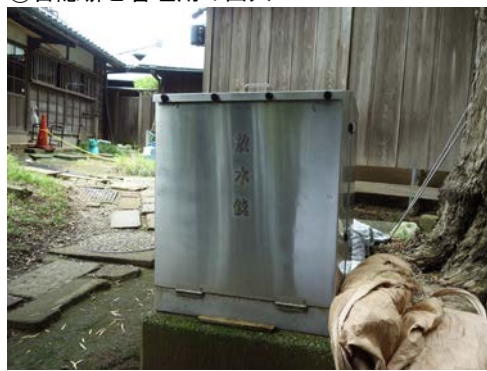
②⑨-1 放水銃(令和7~8年度の工事により撤去予定)
