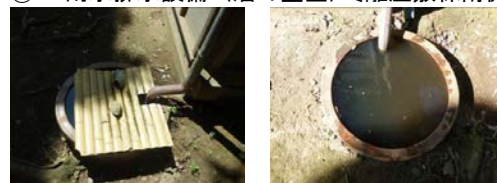
⑭-8 雨水排水設備（溜め壺型）〔離座敷棟東側〕
