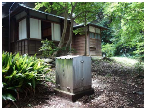
㊹-2 放水銃（令和7～8年度の工事により撤去予定）
