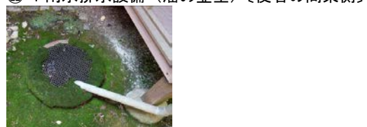
⑭-3 雨水排水設備（溜め壺型）〔使用者の間北側〕
