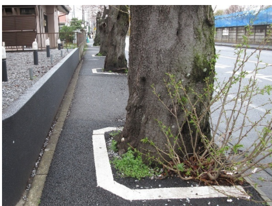
幅員2mの歩道にソメイヨシノが植えられている。この写真の状況でも厳しいが、このままでは今後さらに厳しくなる。
