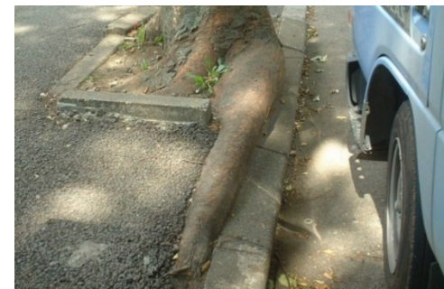
ケヤキは地表近くに根が伸びやすく、根上りや縁石を動かす原因となる。
