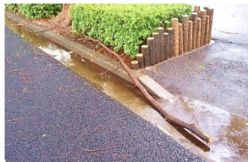
枯れ枝の落下
