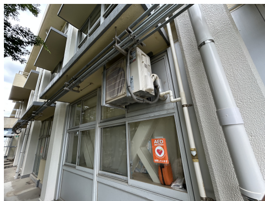
No. 8 冷媒管、ドレン配管
