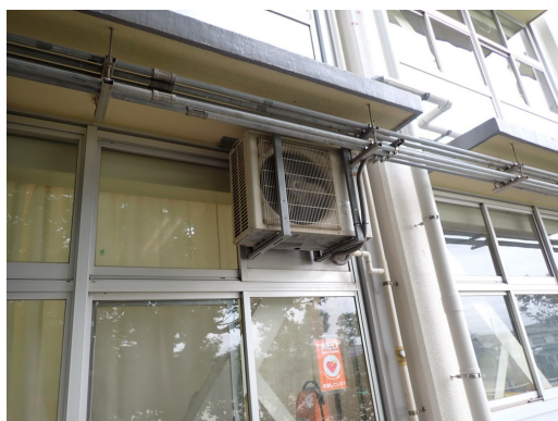
No. 7 冷媒管、ドレン配管
