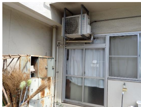
No. 8 冷媒管、ドレン配管
