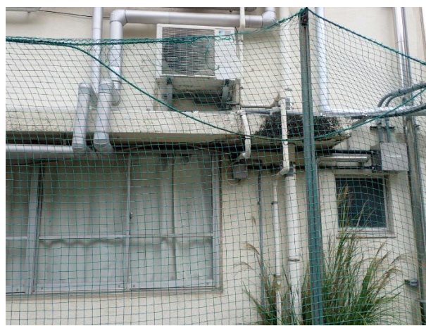
冷媒管、ドレン配管
