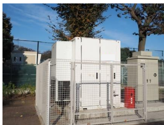
図2 武蔵野市クリーンセンターに設置する蓄電池
