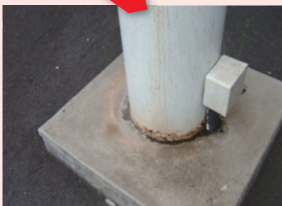
ポールの根元にサビが発生
