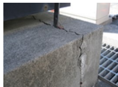
看板基礎のひび割れ
