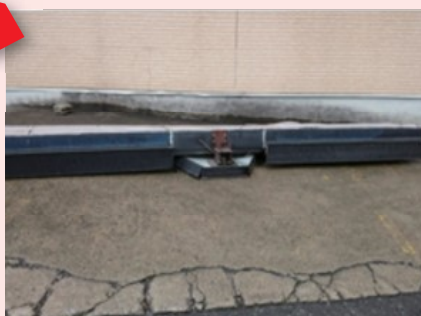
落下した欄間看板
