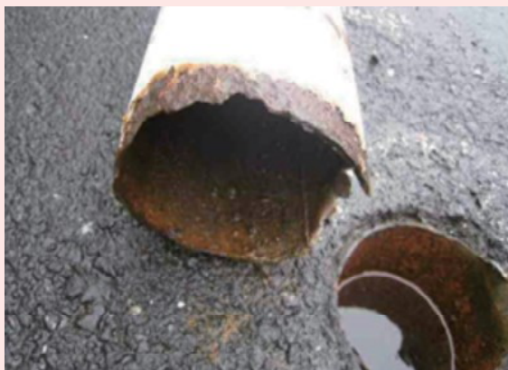
ポールの根腐れによる倒壊
