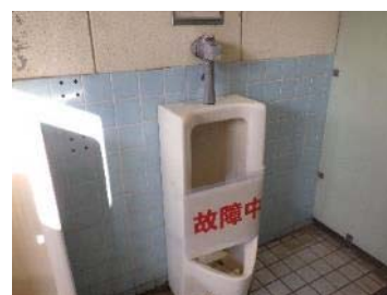
トイレの老朽化状況
