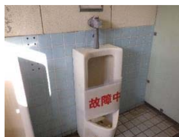
トイレの老朽化状況
