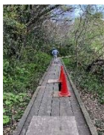
通路の老朽化状況
