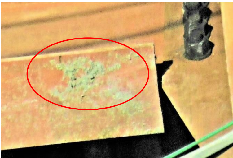
鉄骨梁下の取り残し
