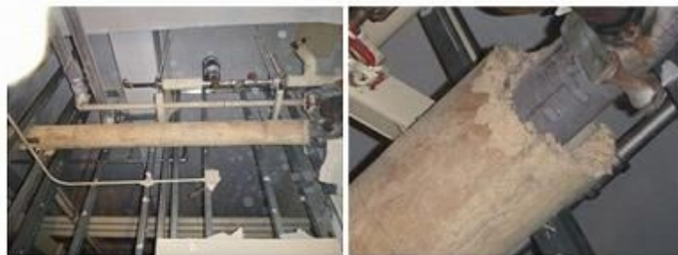
綿テープ類を剥した処すべてに練り保温材が施工されていた。
