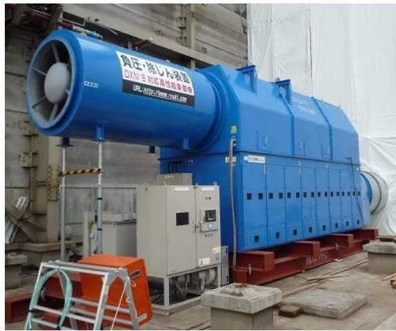
写真Ⅲ－1 大型集じん・排気装置の例（定格風量1,800m 3 /分）
