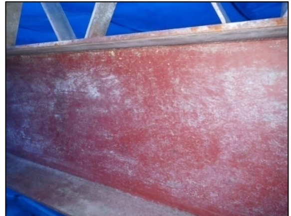
図 4.7.70 再付着した石綿の例
