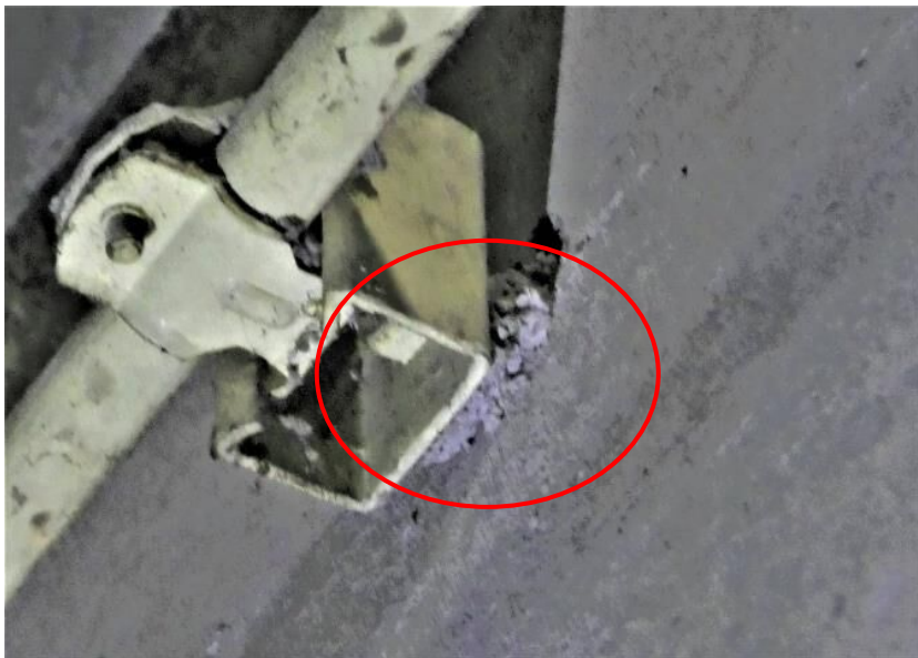
電線管ダクター部の清掃不良
