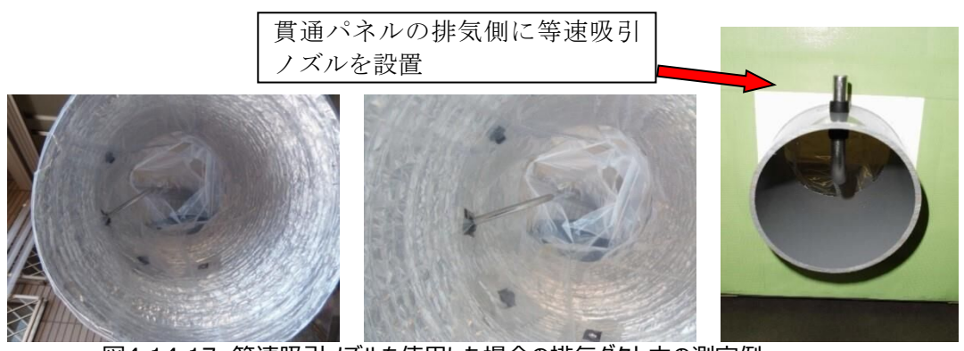
図4.14.17 等速吸引ノズルを使用した場合の排気ダクト内の測定例
