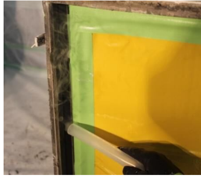
図 4.7.49 HEPA フィルタ周辺部分
