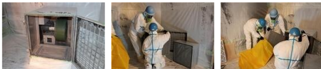
図 4.7.85 HEPAフィルタの交換
