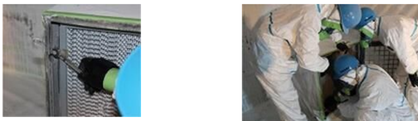
図 4.7.84 HEPAフィルタの留め付の緩み点検
