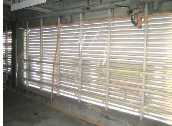
図 4.7.24 外壁の隔離例 (ガラスの手前をプラスチックシート等で隔離)
