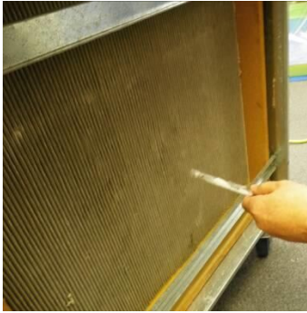
図 4.7.48 HEPA フィルタ面
