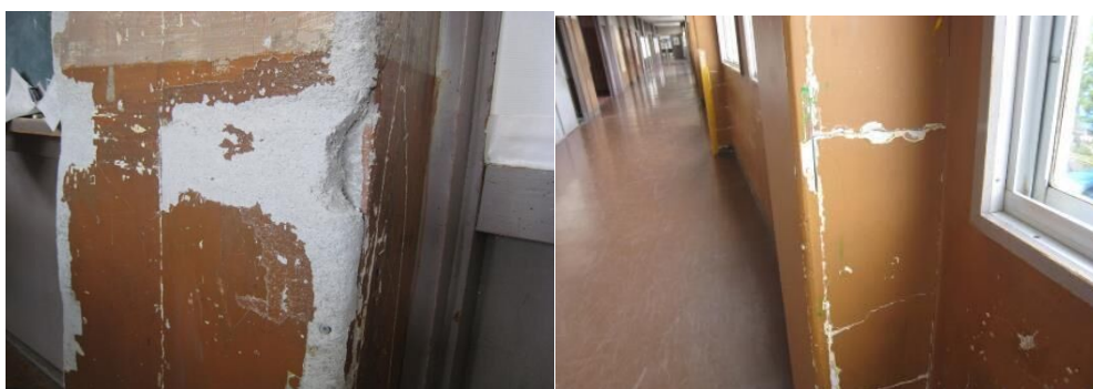
(参考資料) 写真 6-13 鉄骨造校舎 教室・廊下の柱 長年の接触により欠損している
