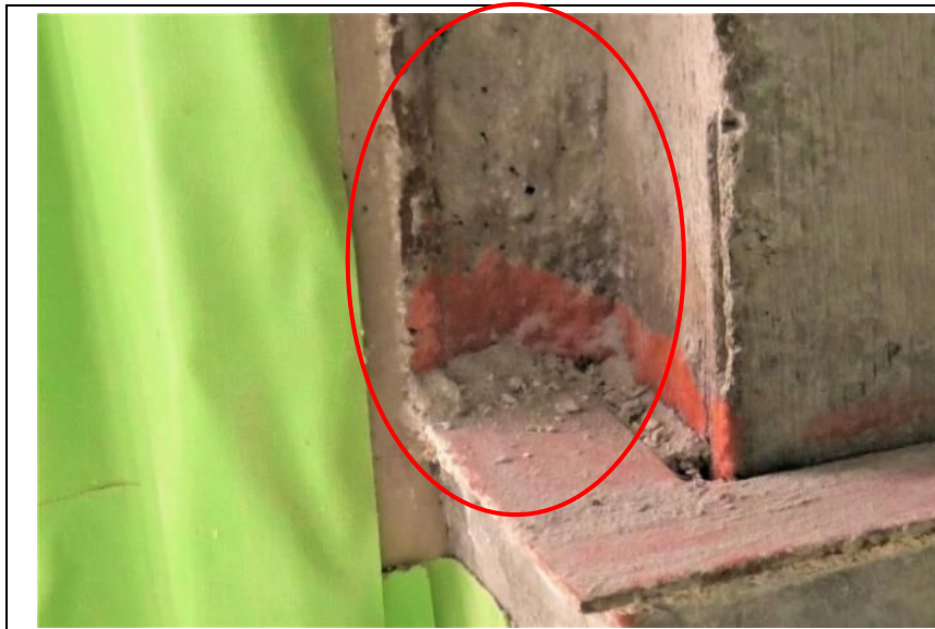
腰壁入隅部の清掃不良
