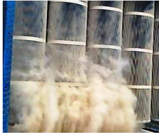
写真Ⅲ-3 フィルタ自動再生状況
