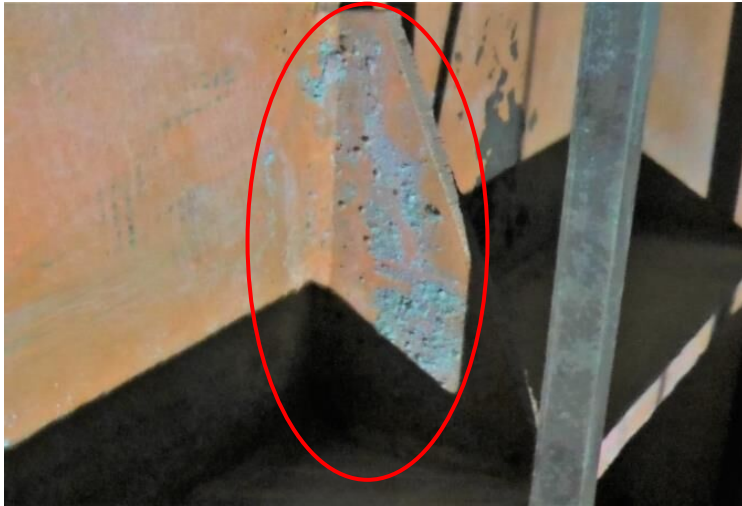
鉄骨梁側面の取り残し
