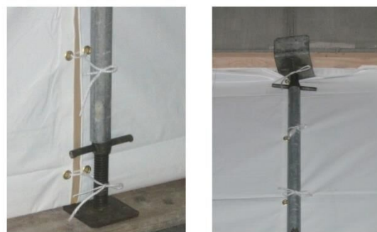
図 4.7.20 防災シートの固定詳細（左：足元。単管にベースジャッキを挿入。右：頭部。単管に根太受け金物を挿入）
