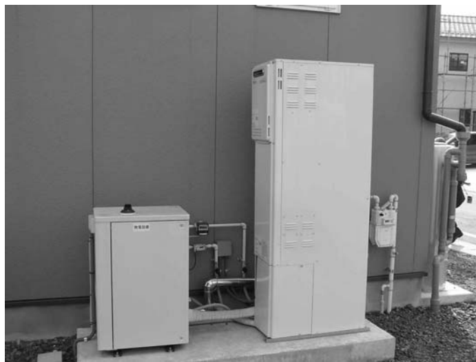
コージェネレーションシステム
