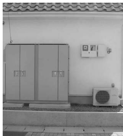
蓄電池や計測機器を収納する「屋外収納庫」
