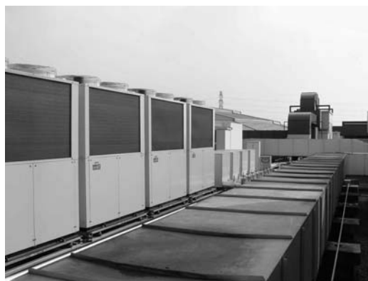
学習文化センター屋上の空調設備
