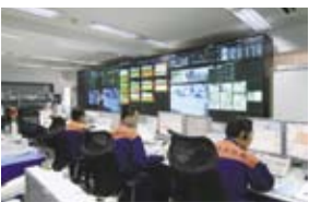
松戸市消防局指令管制室
