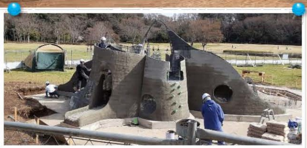
土台の上に遊具「昆虫のスミカ」のかたちができてきました。滑ったり登ったり、中をくぐって遊べる遊具です。モルタルを塗って成形しています。複雑な形をしていますね。
