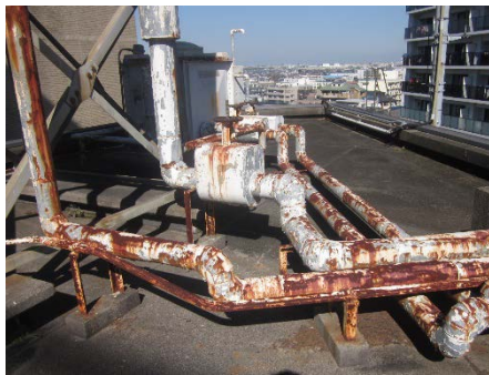
図 4-2-7 錆びついた給水管
