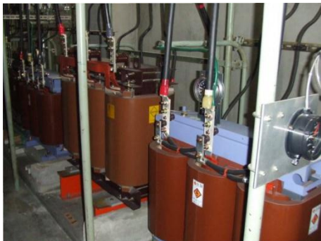
図 4-2-13 旧式電気設備
