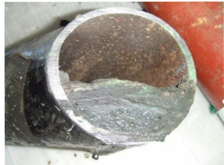
図 4-2-8 堆積物による排水管詰まり
