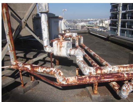
図 4-2-7 錆びついた給水管
