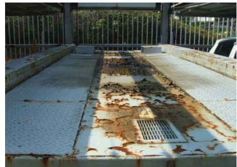
図 4-2-14 立体駐車場の腐食
