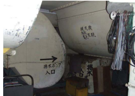
図 4-2-12 老朽化する空調関連設備
