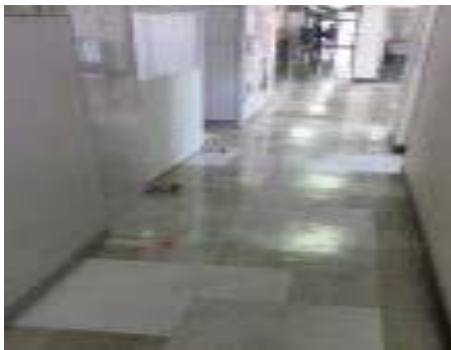
図 4-2-17 狭あいな通路
