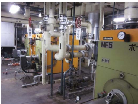
図 4-2-11 更新時期を迎える熱源設備
