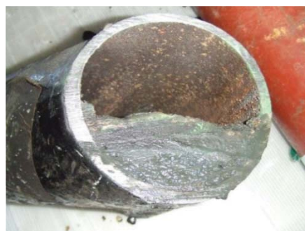
図 4-2-8 堆積物による排水管詰まり
