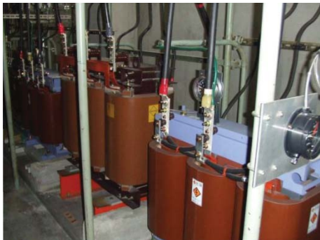
図 4-2-13 旧式電気設備
