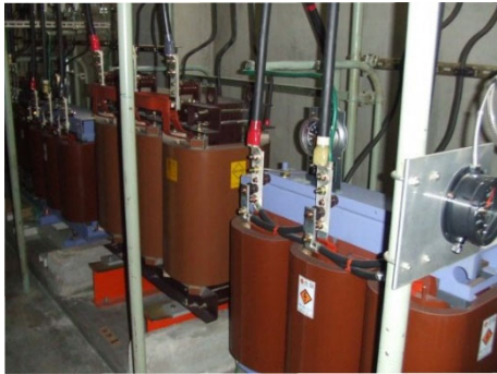
図 21 旧式電気設備
