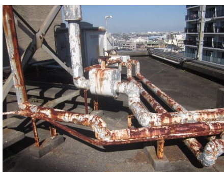
図 15 錆びついた給水管
