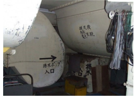
図 20 老朽化する空調関連設備
