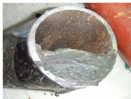
図 16 堆積物による排水管詰まり
