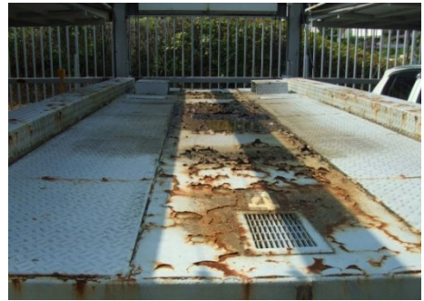
図 22 立体駐車場の腐食
