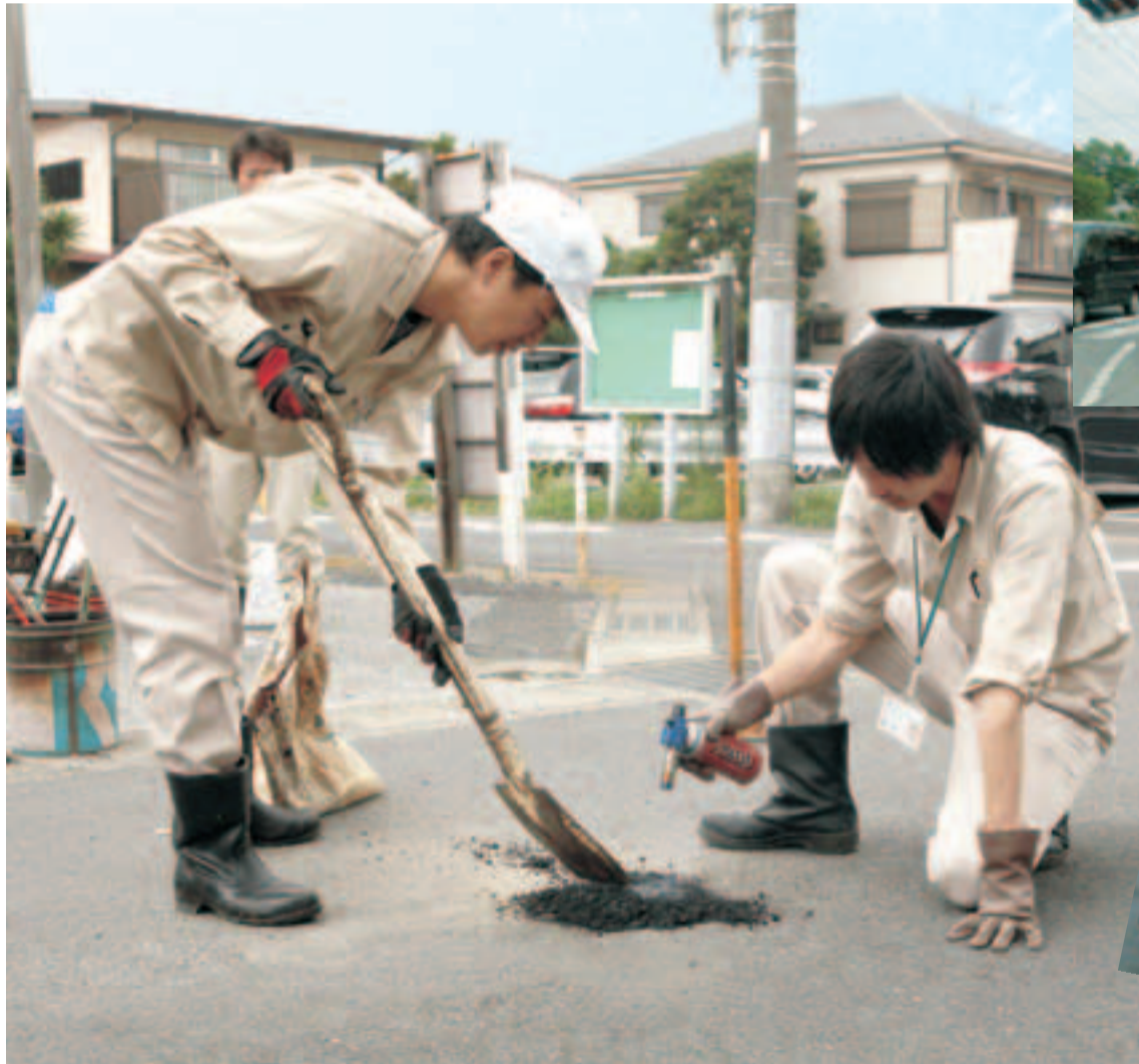
道路の陥没を発見。陥没は、歩行者・二輪車等の事故につながるため、迅速に補修
