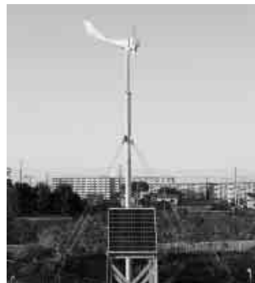
「風力・太陽光発電装置」上部のプロペラが風力を、下部の四角い装置が太陽光を集め、電力へ変えます
