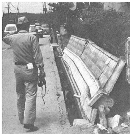
地震で倒壊したブロック塀 (昭和58年の日本海中部地震)
