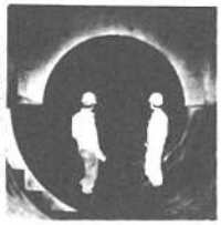
管の直径四・一メートル
