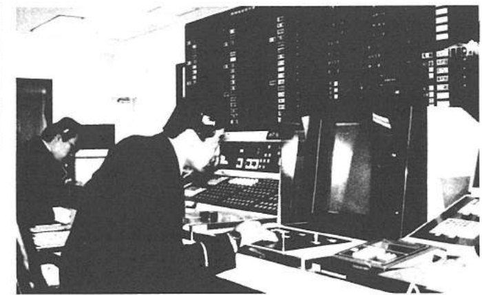
24時間市内を監視する指令室
