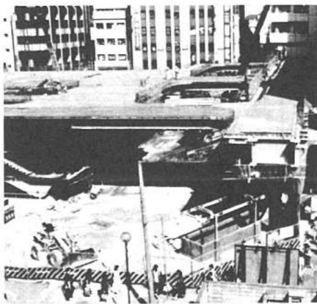
地下駐車場も着々と工事が進み整備される松戸駅西口駅前
