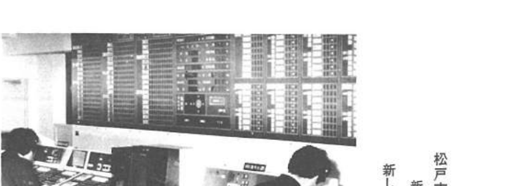
最新の機器を導入した通信司令管制室
