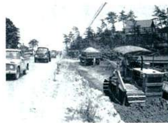
車の交通量増大に対処するため国道6号線の拡幅工事がおこなわれた。（昭和41年頃）
