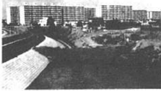
完成が待ち望まれる北千葉導水路
