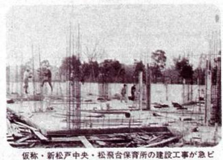
仮称・新松戸中央・松飛台保育所の建設工事が急ピッチで進行中。
