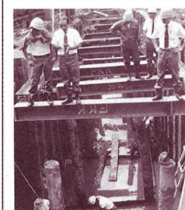
浸水地域の解消めざし排水路整備は重要施策
