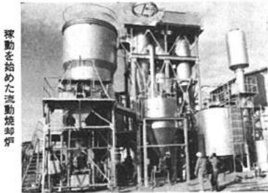
稼働を始めた流動焼却炉
