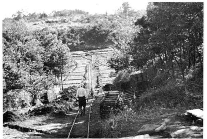
◇新国道6号線工事着工（昭和31年）…旧水戸街道に代わる新国道工事が着工されました。 ＝岩瀬の工事現場＝
