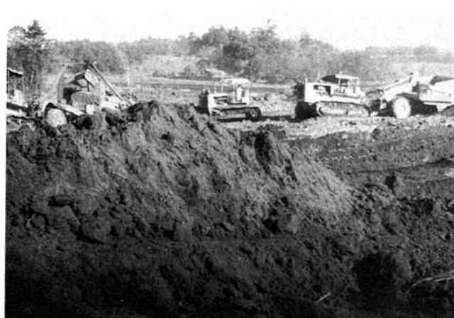
◇小金原団地造成進む（昭和43年）…約230ヘクタール、3万人の住宅都市を想定した小金原団地造成は着々工事が進められました。
