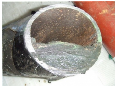
図 4-2-8 堆積物による排水管詰まり
