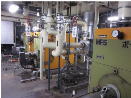
図 4-2-11 更新時期を迎える熱源設備
