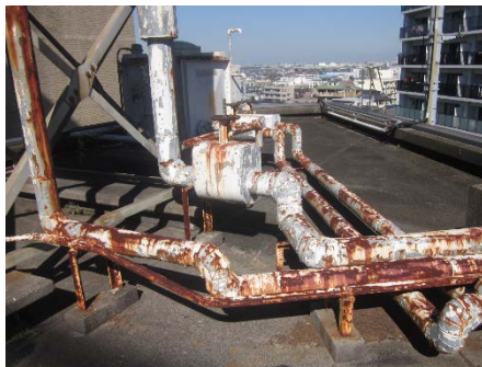
図 4-2-7 錆びついた給水管
