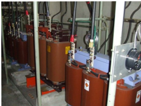
図 4-2-13 旧式電気設備
