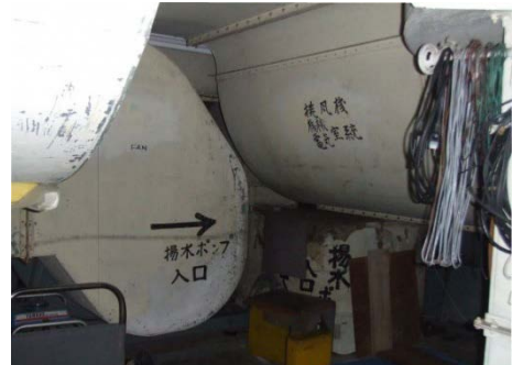
図 4-2-12 老朽化する空調関連設備
