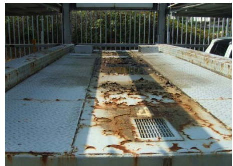
図 4-2-14 立体駐車場の腐食
